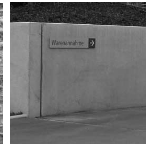
MAUER Fertigteil aus Sichtbeton, konstruktive Fase
