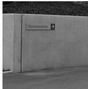
MAUER Fertigteil aus Sichtbeton, konstruktive Fase
