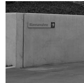
MAUER Fertigteil aus Sichtbeton, konstruktive Fase
