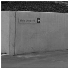
MAUER Fertigteil aus Sichtbeton, konstruktive Fase
