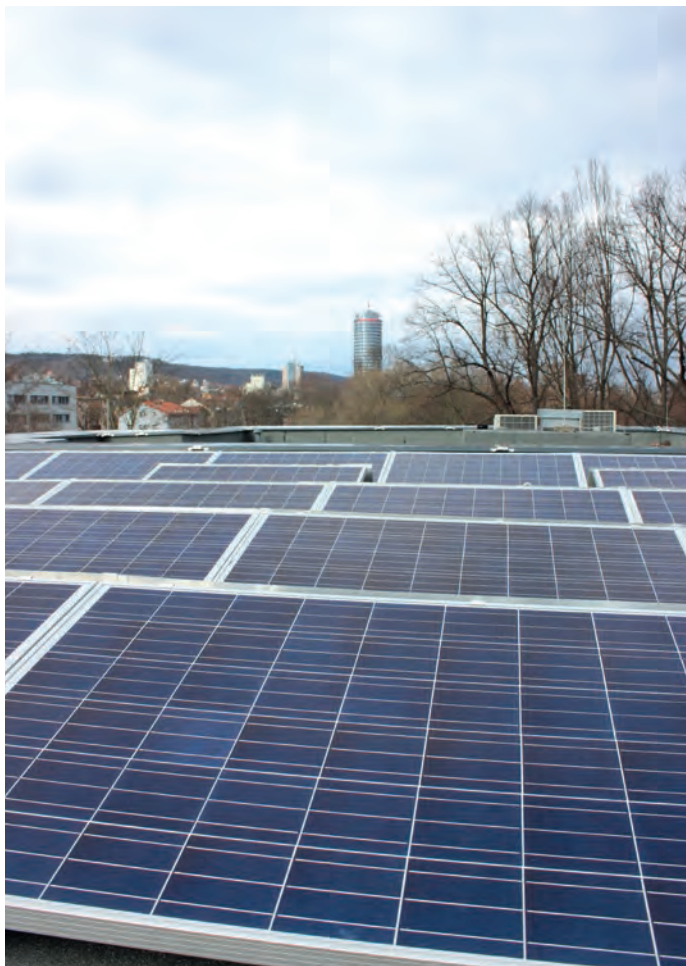
Abbildung 3: Photovoltaik-Anlage auf dem Dach der Freien Gesamtschule UniverSaale Jena (2016)
